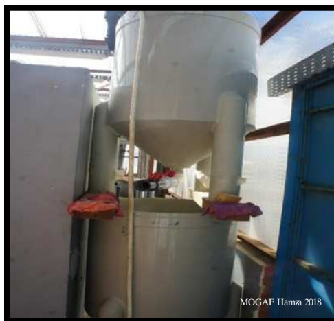
Figure 39 : photo du décanteur 1.
