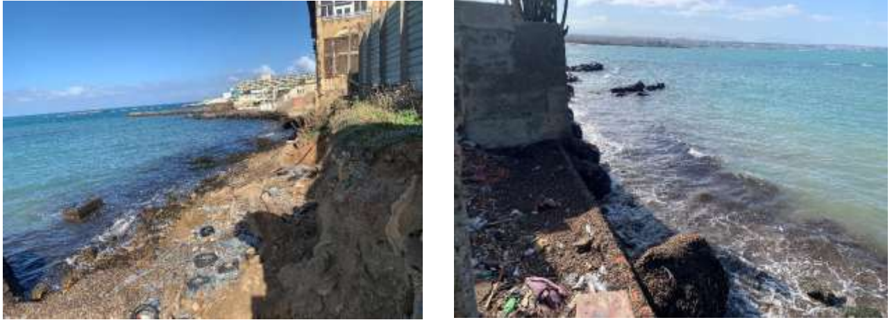
Figure 3 : L'état du talus qui surplombe la zone d'étude (LEM-2024).
