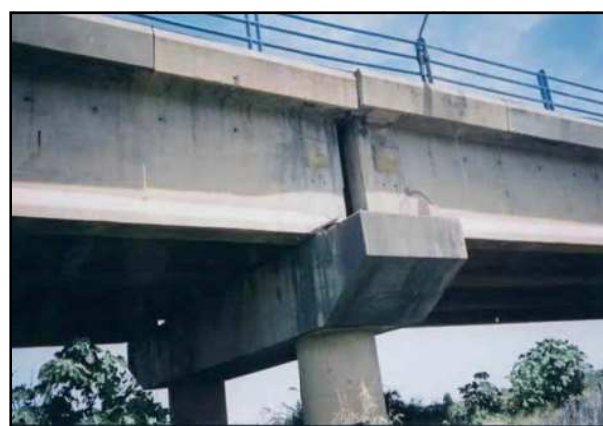
Figure I.4 : Déplacement latéral et longitudinal du pont d'Isser (Boumerdes, 2003)
