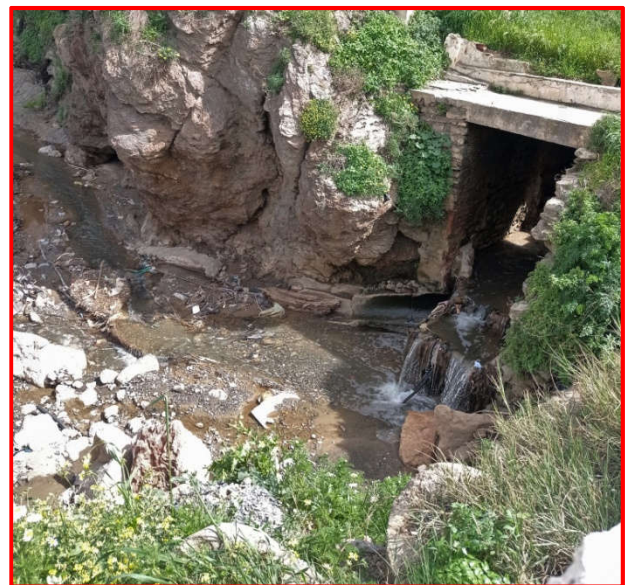
Figure 24 les eaux usées et les rejets de la cimenterie verse directement vers la plage (2022)
