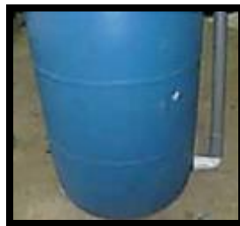
Figure 13 : Tuyau de drainage au fond du filtre mécanique.
