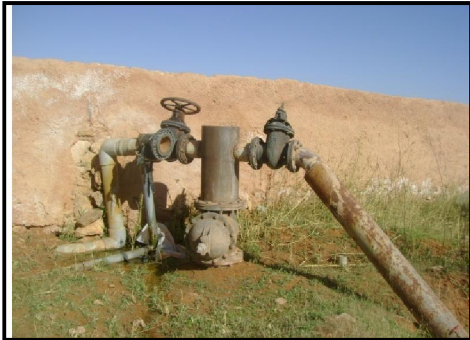
Figure N° 5: la tête du forage (ferme EZZAHRA).
