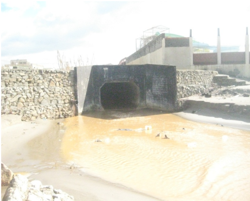
Figure5 : Emissaire d'un rejet à proximité de la moulière de Zérlda.
