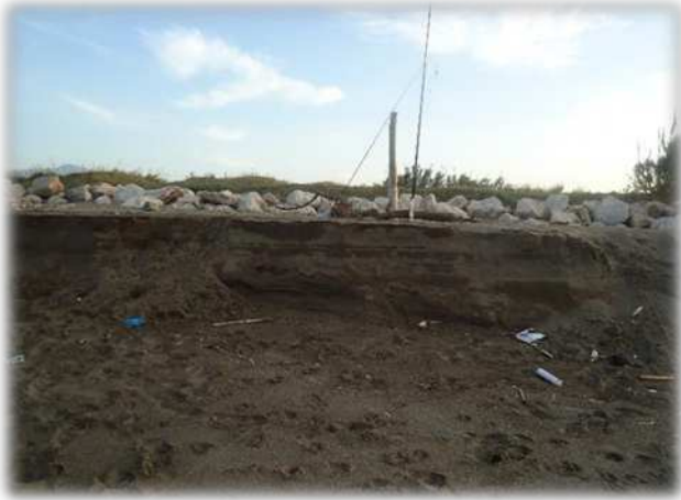
Photo n°22 : Etat d'érosion de la plage de Sidi Ali Lebhar
