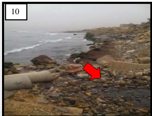
Photo n°8 : Vue vers l'Est du port, un rejet d'eau usée
