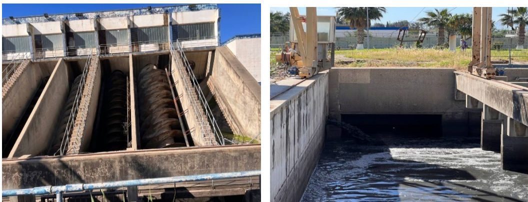
Figure 7. poste de relevage PR1 (photo prise sur terrain 17 avril 2025)
