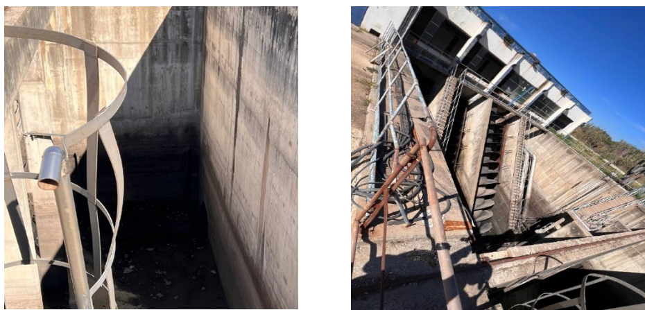
Figure 8. Poste de relevage PR2 (photo prise sur terrain 17 avril 2025)
