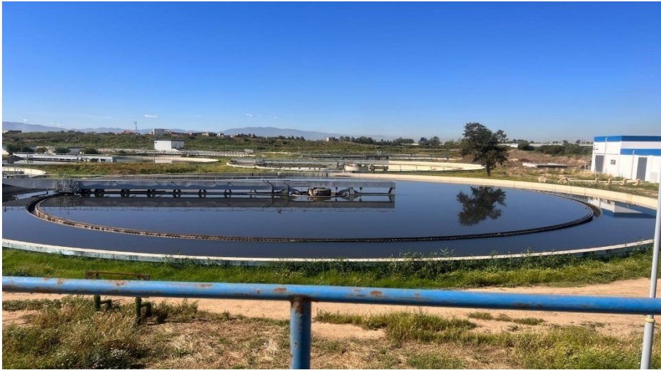
Figure 14. Décantation primaire (photo prise sur terrain 17 avril 2025).
