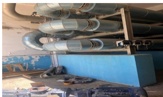
Figure 23Echangeur de chaleur de la STEP (Photo prise sur terrain avril 2025)
