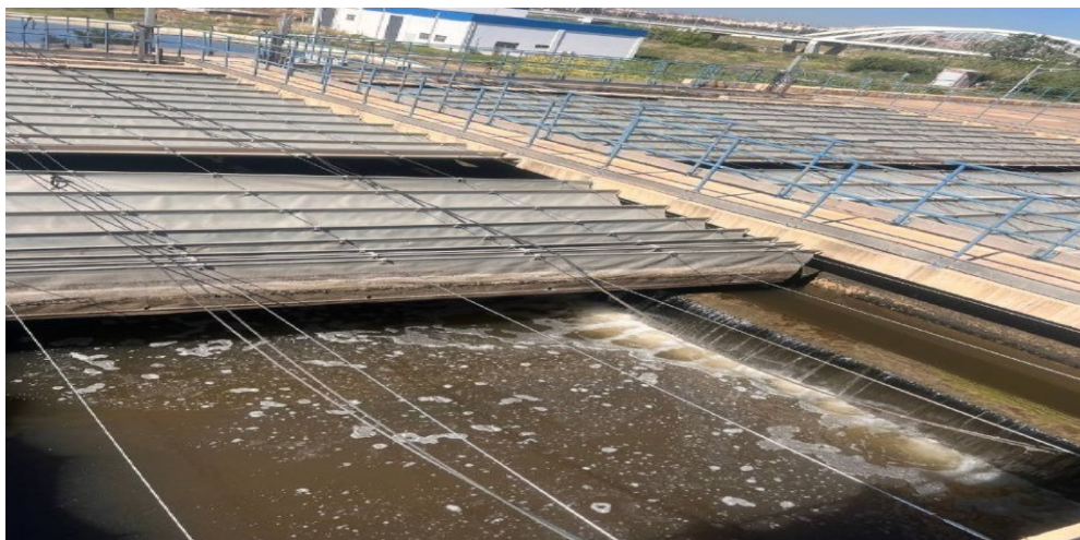
Figure 18. Filtre à sable (filtration par filtres Aquazur®)
