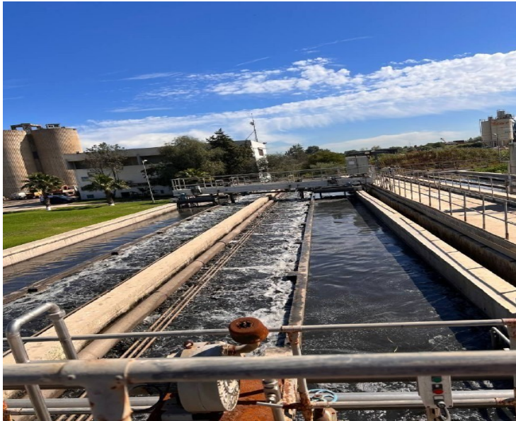
Figure 13. Dessableur-Déshuileur (photo prise sur terrain 17 avril 2025).
