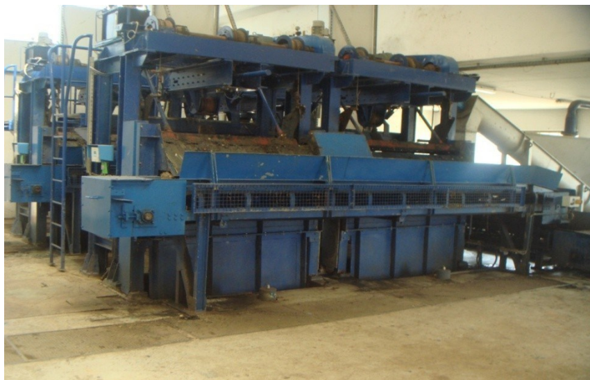
Figure 10. Dégrilleurs mécanique fin et grossier
