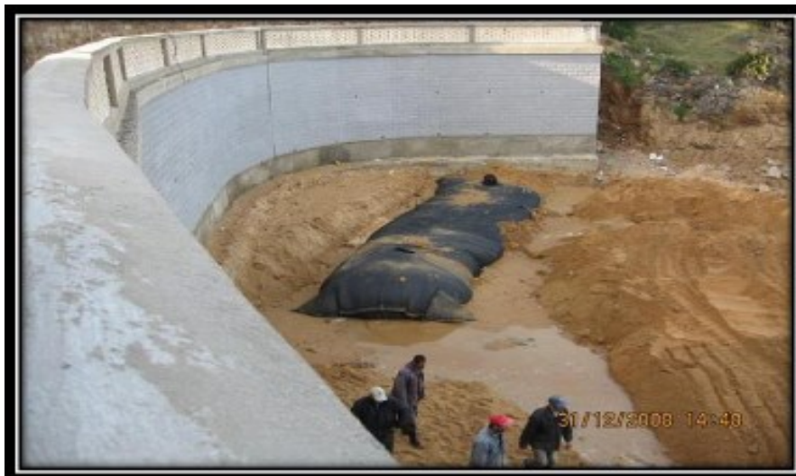
Photo V.3: Les ouvrages en géotextile ( https://www.memoireonline.com )
