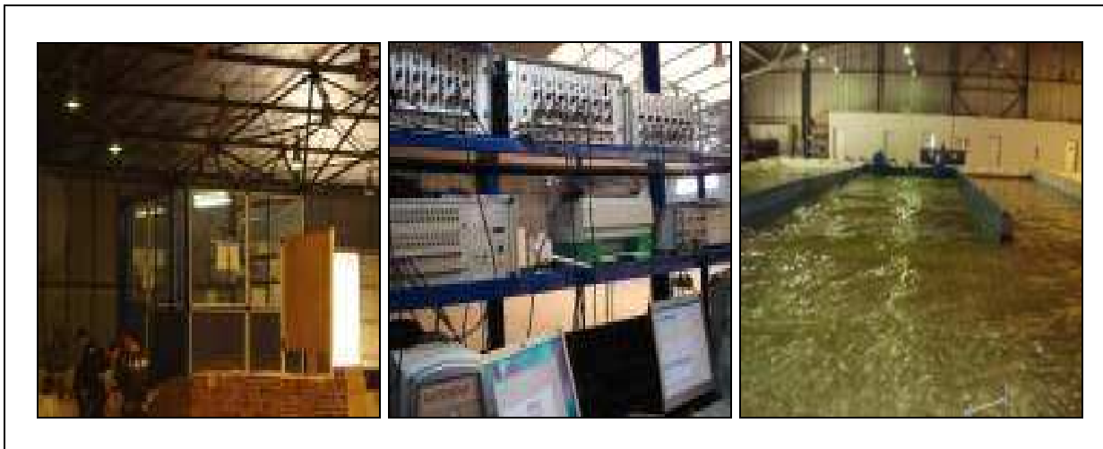
Figure VI.16 : Chambre de pilotage lié au bassin et dispositif électronique de génération des houles, laboratoire du LEM.
