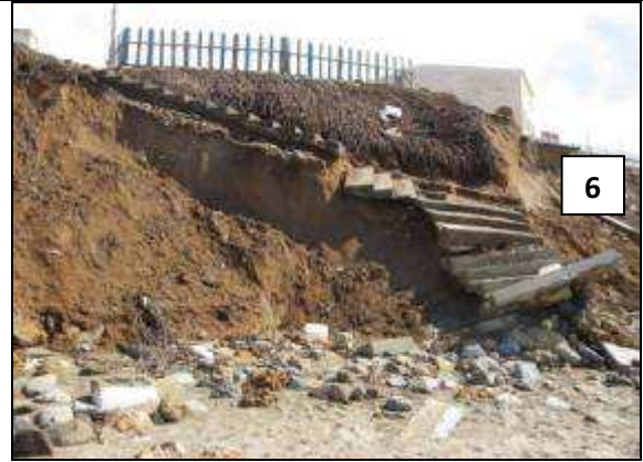
Photo 9 : Importants dégâts causés par la tempête : érosion et destruction des escaliers menant à la plage.
