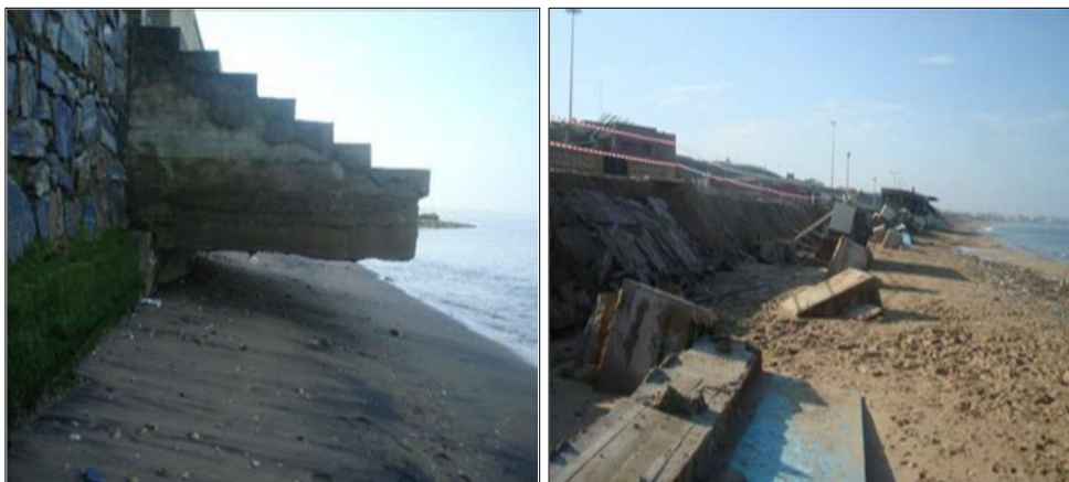
Figure 3 : Dégâts observés au niveau de la plage Club des Pins lors de la tempête de 2007
