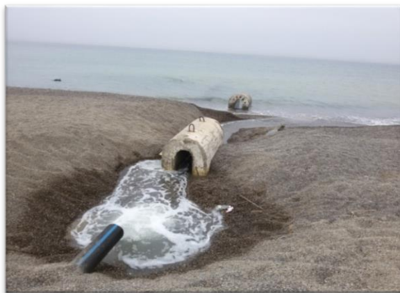
Figure (67): Rejet de la station de dessalement d'Azur.
