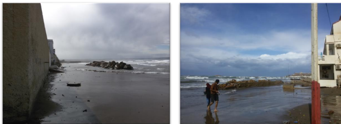
Figure (66): Forte érosion à la plage Ouest.
