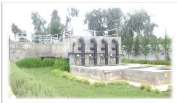
Figure 5 : Le poste de relevage.
