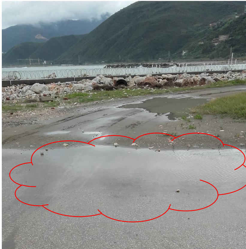
Figure 14: Le problème de franchissement de la houle au bout de piste de l'aéroport de Béjaia
