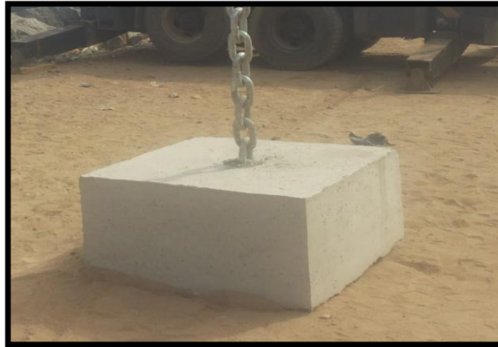
Figure 38 : Photo d'un corps-mort avec une chaîne.
