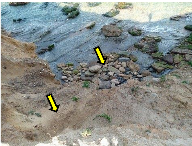
Figure IV-63 : a et b : Traces d'effondrement des parois de la falaise de Zerouria (2018),
