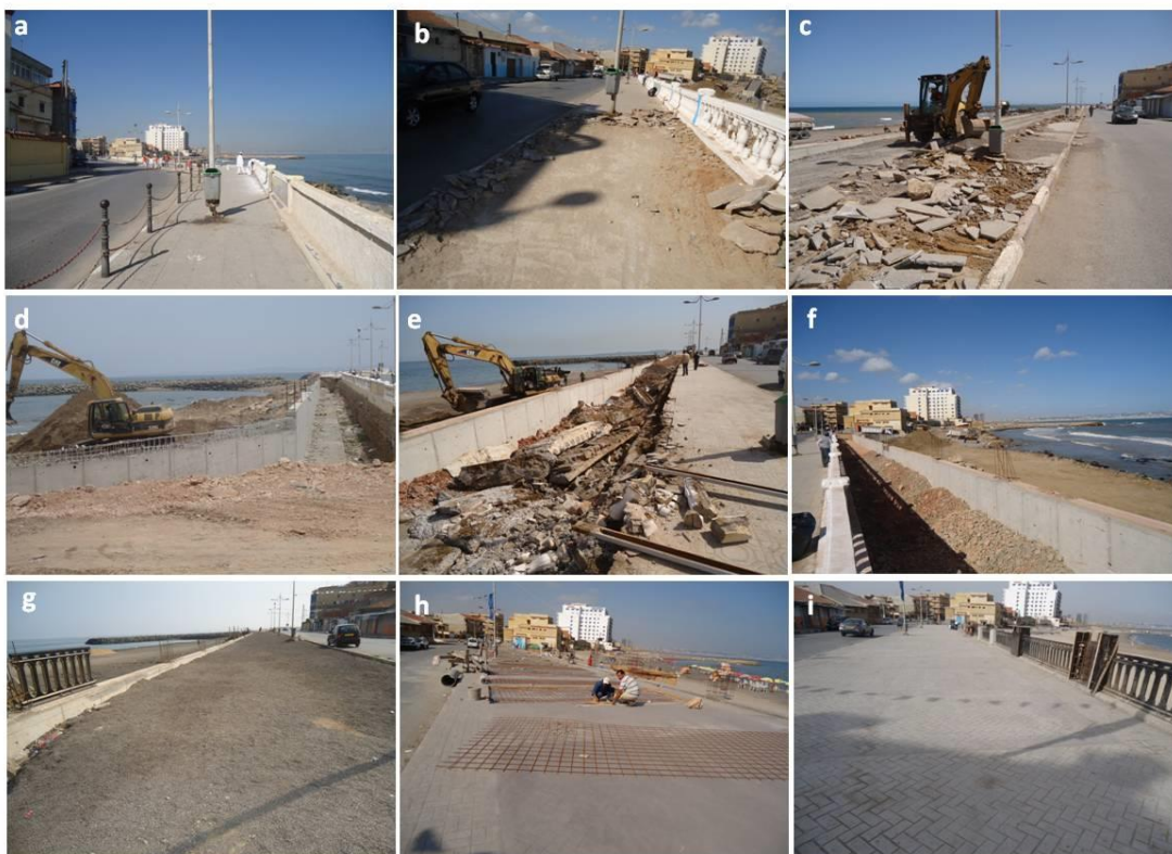
Figure III-13 : a : Contrôle sur terrain des points en place ; b, c, d, e, f, g, h, et i : perte d'un point géodésique en raison de travaux d'aménagement (2016).
