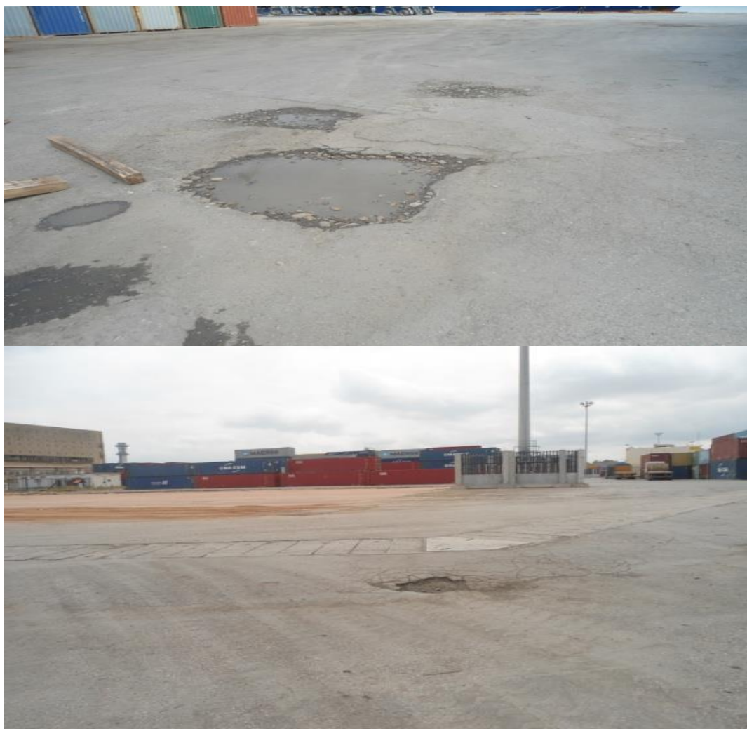
Figure 18 : détérioration de la chaussée.
