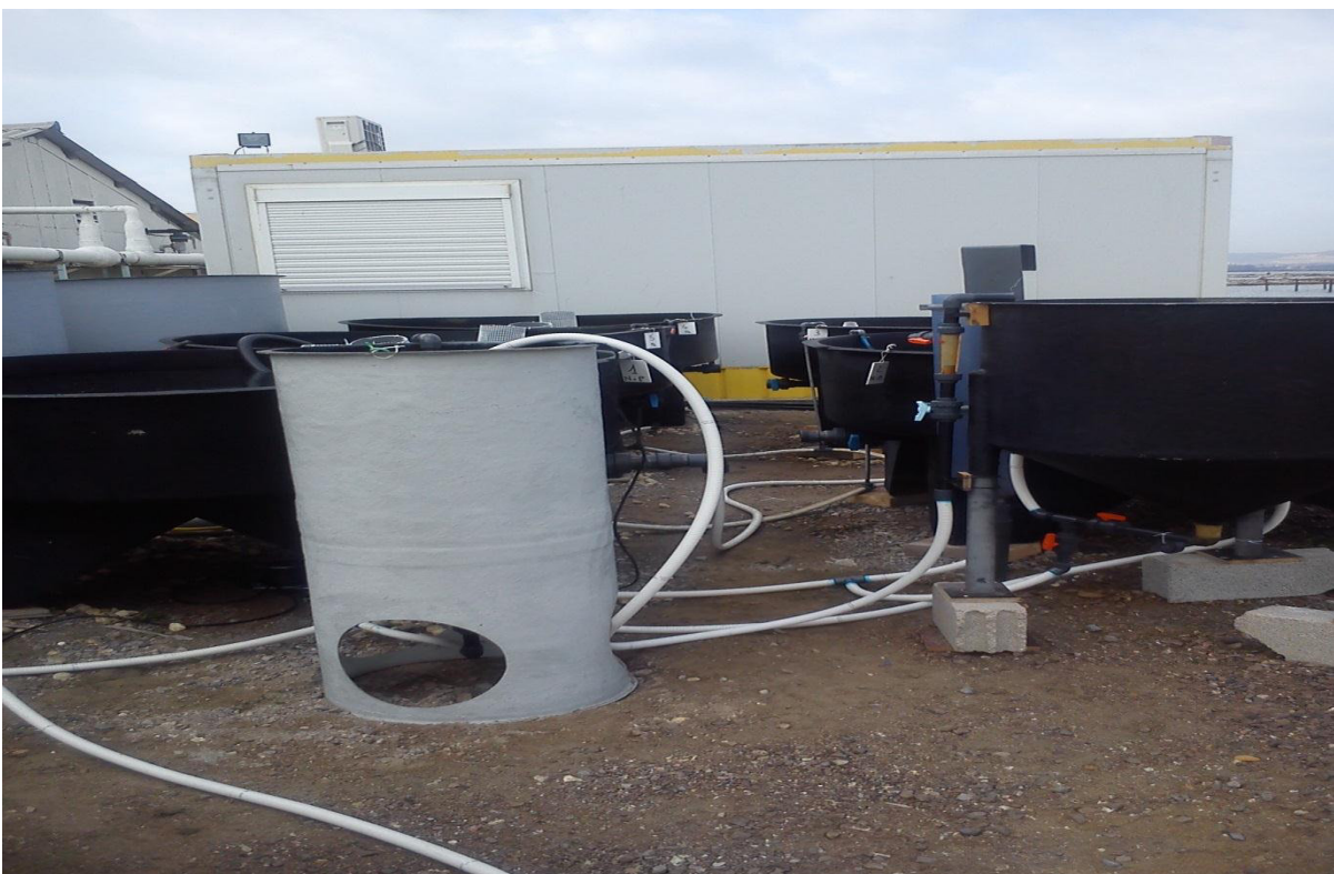
Figure 11 : système d'intégration à l'extérieur (station IFREMER).
