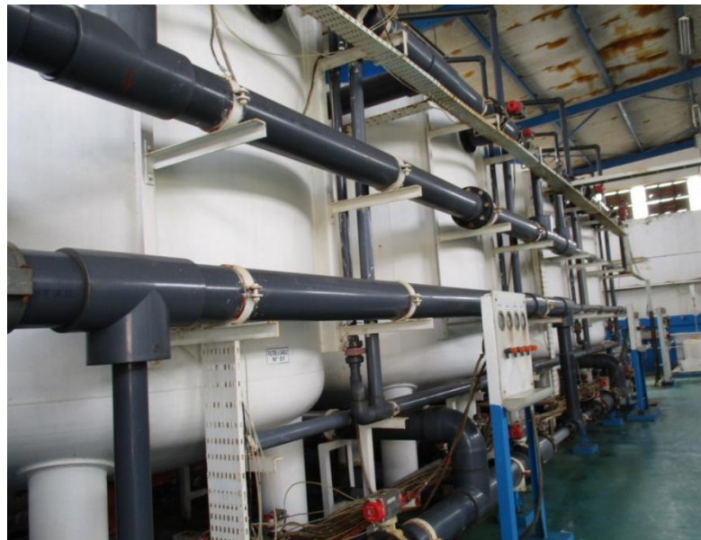
Figure 16 : Illustration des filtres à sables de la station de dessalement de Palm-Beach (AA.ADEM, 2017)
