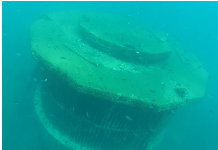
Figure 22 : Dispositif de prise d'eau de mer de la station de dessalement de Fouka 1
