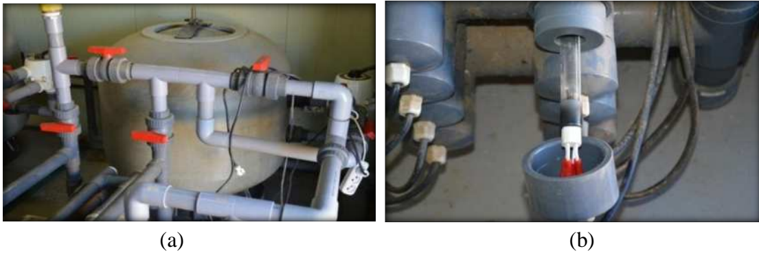
Figure 20 : Système de filtration de l'eau et de traitement à ultra violets (a) filtre a sable ; (b) filtre ultra violet, Ferme pilote d'EL MARSA-Skikda
