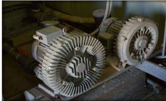
Figure 22 : Aérateurs, ferme pilote d'EL MARSA-Skikda
