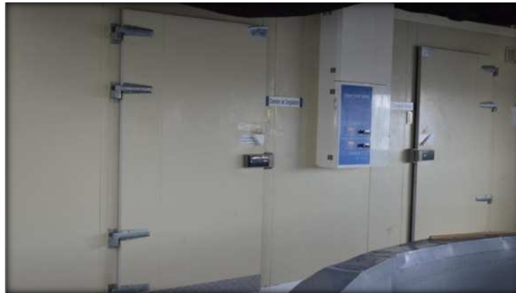
Figure 18 : Chambre froide et de congélation, ferme pilote d'EL MARSA–Skikda
