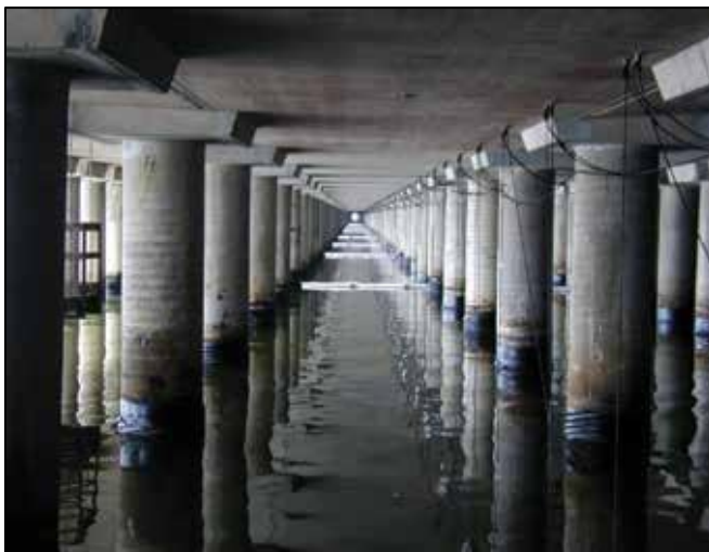
Figure I.34 : L'accès sous des jetées peut être difficile et dangereux pour les équipes de nettoyage en raison du manque d'espace de manœuvre et de ventilation.
