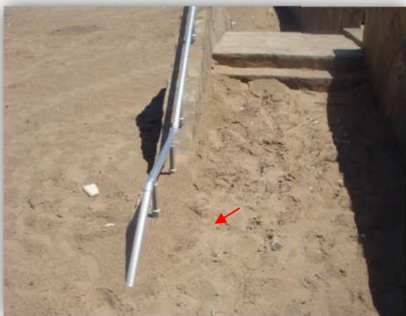
Photo n°5 : Recouvrement des escaliers par le sable.
