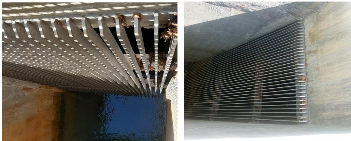
Figure III 5: Système de dégrillage installé au niveau de la station d'El Marsa (AYOUNE and CHEAIBI, 2024)
