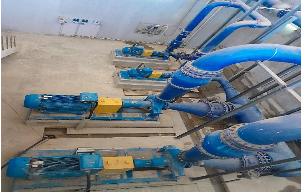
Figure III 10: station de pompage de l'eau traitée au niveau de la station d'El Marsa ( Photo prise par AYOUNE et CHEAIBI )
