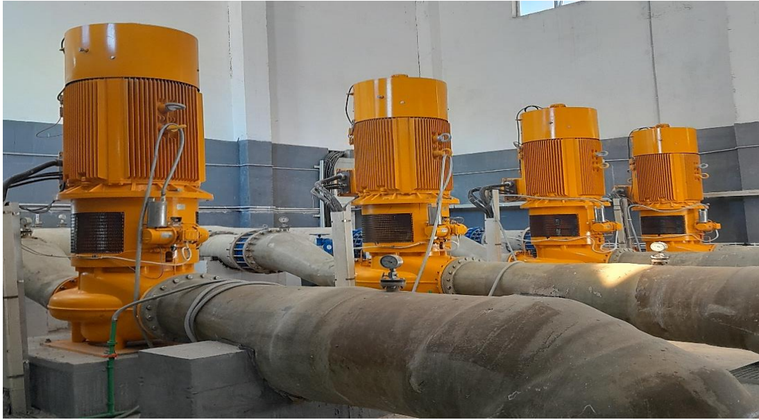
Figure III 7: Système des Pompes aspirantes installés au niveau de la station d'El Marsa ( Photo prise par AYOUNE et CHEAIBI )
