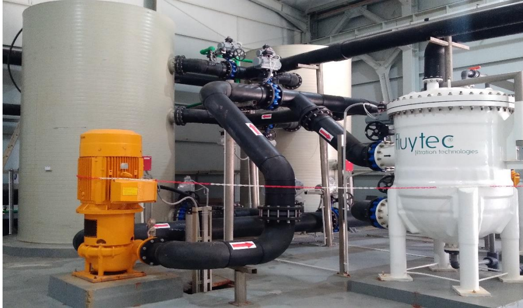
Figure 2: système de nettoyage des membranes unité CIP
