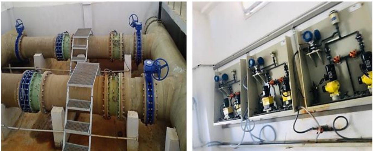
Figure III 8: Lieu d'injection du coagulant et du floculant au niveau de la station d'El Marsa
