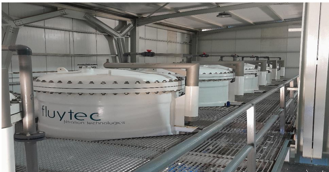
Figure III 9: Système de filtration à cartouches installé au niveau de la station d'El Marsa (Photo prise par AYOUNE et CHEAIBI)
