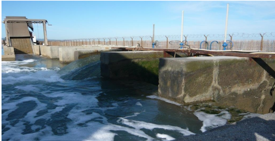
Figure n°7: le pompage de l'eau vers le filtre mécanique
