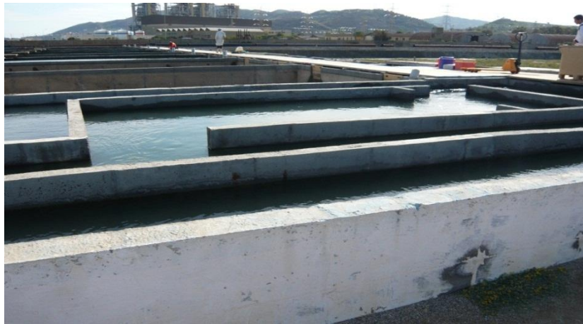
Figure n°12: bassin de décantation
