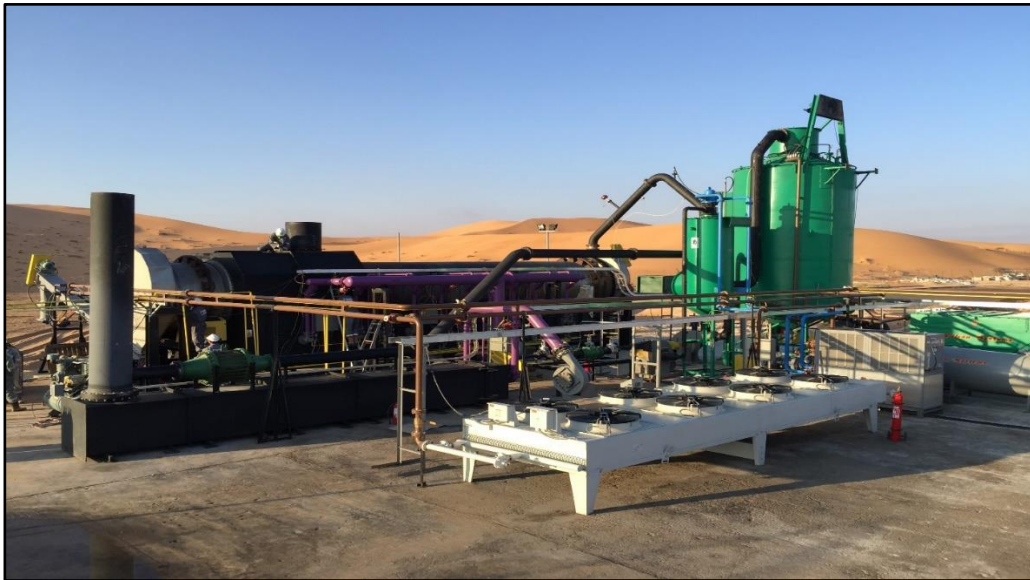
Figure 15 : Station de désorption thermique par chauffage indirect - Environmental Solutions
