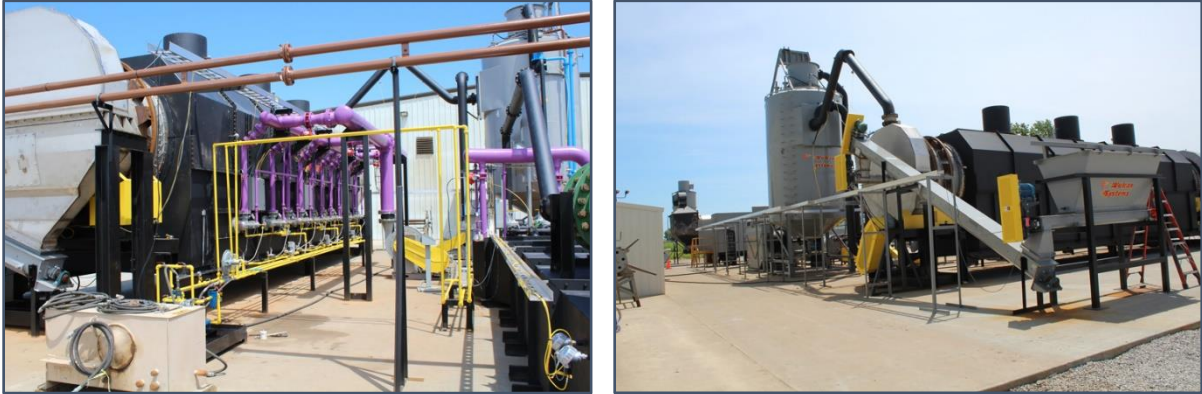
Figure 18 : Unité de désorption thermique par chauffage indirect- Environmental Solutions
