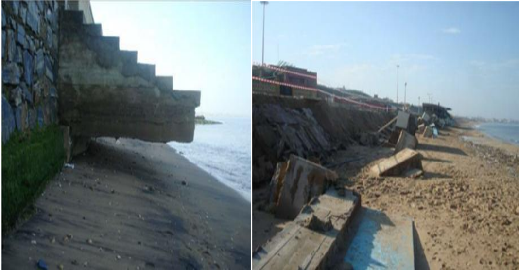
Figure 3:dégâts observés après la tempête de 2007(source APDO LEM 2008)
