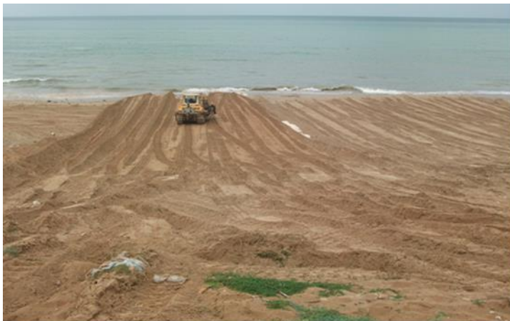
Figure 82: L'étalement du sable sur la plage avec une pente de 15/1 au moyen d'un bulldozer
