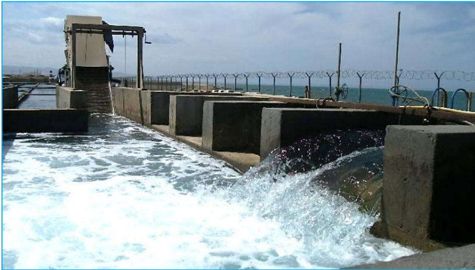
Figure 37 Remontée d'eau grâce à l'une des pompes installées
