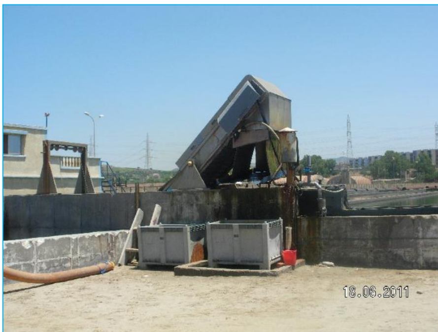
Figure 43 Filtre mécanique à l'œuvre (en amont du canal principal)
