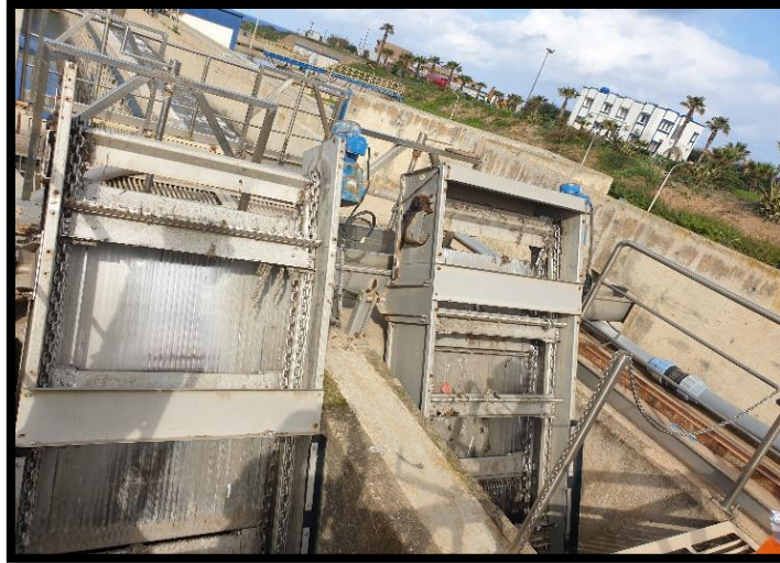
Figure II.5 Dégrilleur fin (KENNICHE, D., et BOUKHARI, I).
