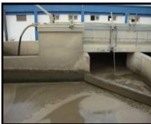
Figure II.14 Alimentation de la bache des boues stabilisée Par un déversoir mobile (Notice de Fonctionnement et d'exploitation de la station d'épuration de Beni Messous mise à jour 2021).
