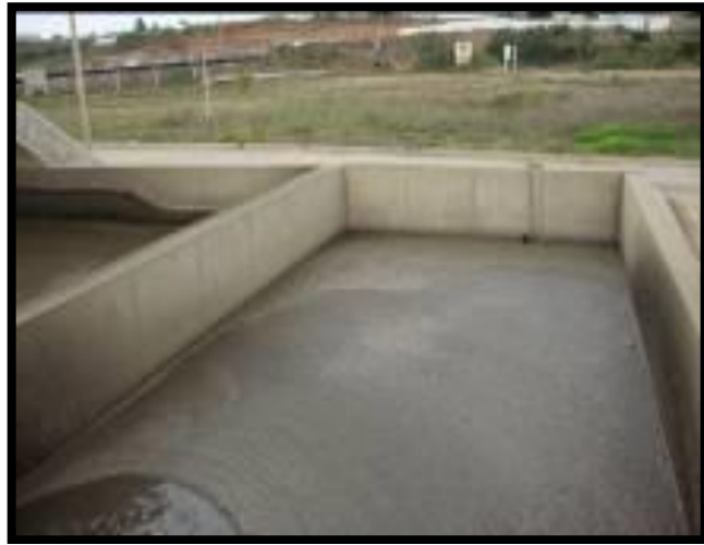
Figure II.15 : Bâche des boues stabilisées (Notice de Fonctionnement et d'exploitation de la station d'épuration de Beni Messous mise à jour 2021).
