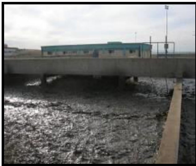
Figure II.13 : Aérateur de surface (Notice de Fonctionnement et d'exploitation de la station d'épuration de Beni Messous mise à jour 2021).
