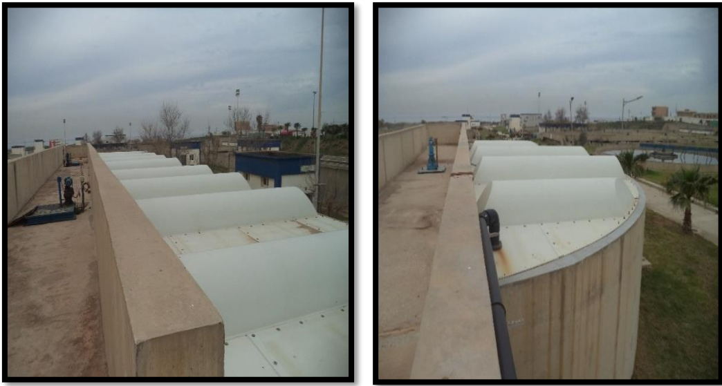
Figure II.12 : Épaissement des boues (Notice de Fonctionnement et d'exploitation de la station d'épuration de Beni Messous mise à jour 2021).
