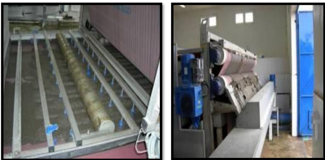
Figure II.16 : Répartition de la boue sur la toile et le Raclage finale de la boue (Notice de Fonctionnement et d'exploitation de la station d'épuration de Beni Messous mise à jour 2021).
