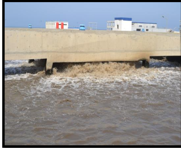
Figure II.8 Bassin d'aération en fonctionnement ( Notice de Fonctionnement et d'exploitation de la station d'épuration de Beni Messous mise à jour 2021 ).
