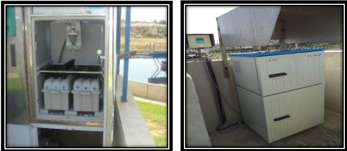
Figure III.17 : Préleveur automatique. (Notice de Fonctionnement et d'exploitation de la station d'épuration de Beni Messous mise à jour 2021).
