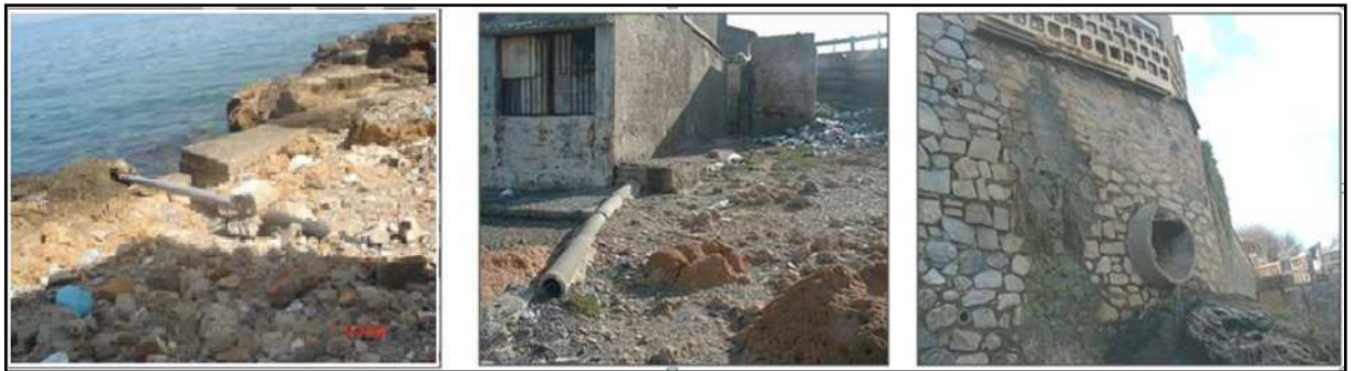
Figure II.40 : Rejets d'eaux usées directement en mer.
