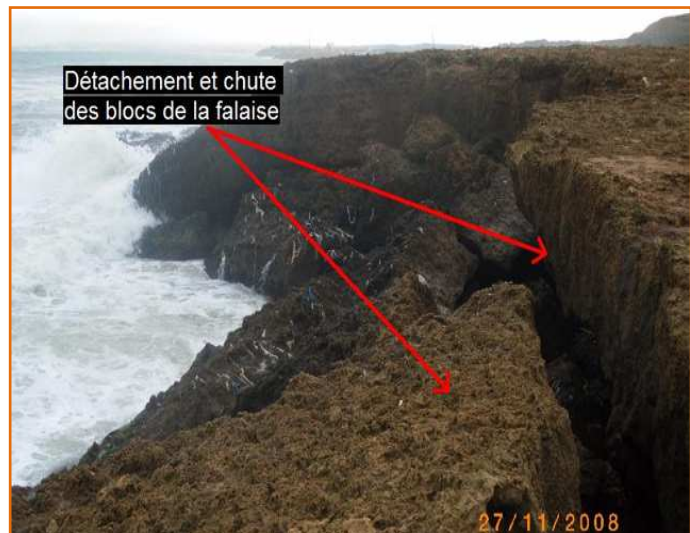
Figure II.12: Chute de blocs de la falaise
