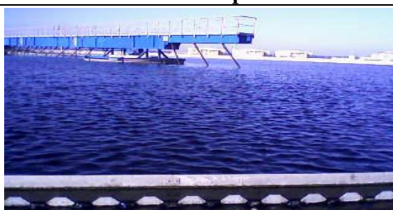
Figure II.11 : Photographie d'un bassin de décantation secondaire.
