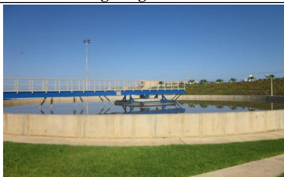
Figure II.09 : Photographie d'un bassin de décantation primaire
