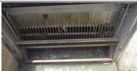
Figure II.07 : Photographie de dégrillage fin
