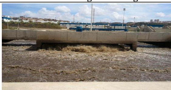
Figure II.10 : Photographie d'un bassin d'aération
