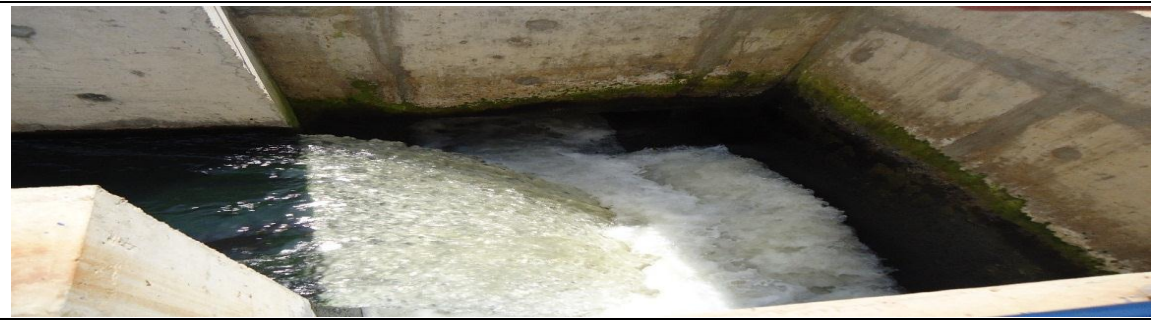
Figure II.12 : Photographie d'un bassin de l'eau épurée
