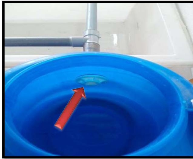
Figure 24 : La sortie d'eau vers le système hydroponique
