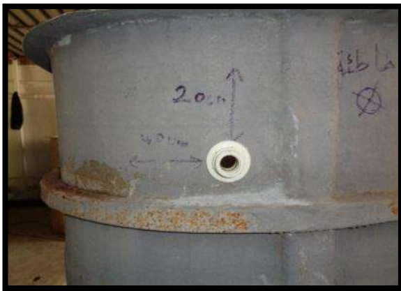
Figure 7 : Trop-plein pour le bassin à poissons
