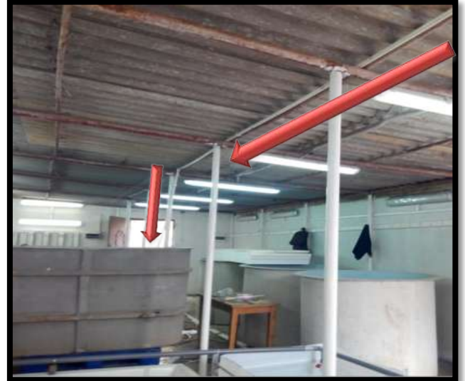
Figure 45 : Tuyau de récupération vers le bac à poisson
