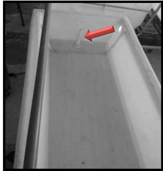
Figure 37 : Trop-plein de 30 cm à l'extrémité du fond
