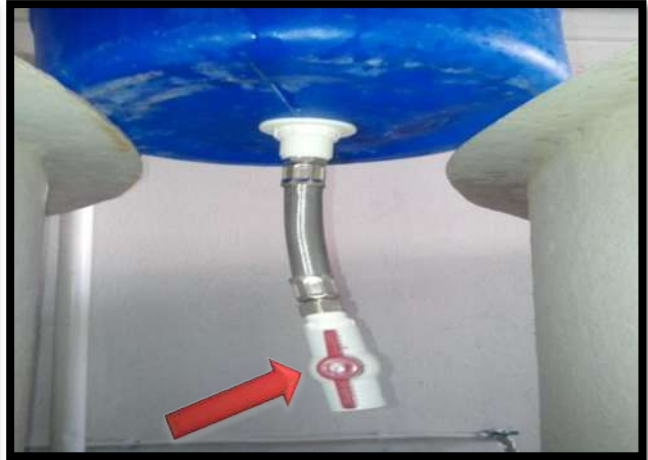
Figure 18 : Robinet d'évacuation au fond du filtre
