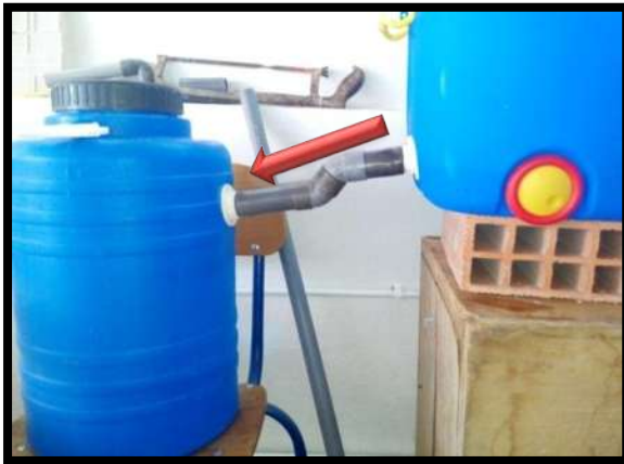
Figure 22 : Emplacement du bio- filtre avec le filtre mécanique
