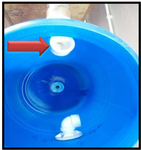
Figure 15 : Le trop-plein par un coude PVC 90°
