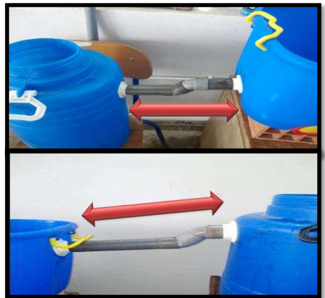
Figure 7 : Tuyaux PVC de 32 mm de diamètre
