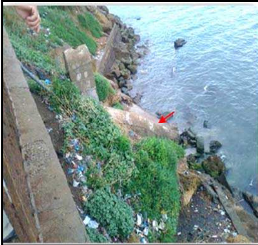
Figure I.2 : Une embouchure d'eaux usées dans la zone
