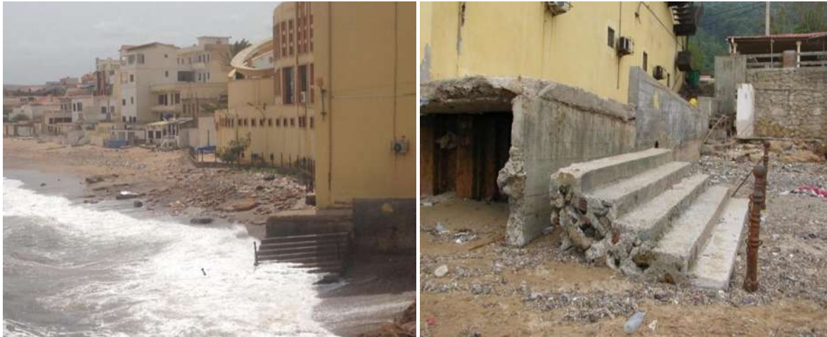
Figure II. 21 : Situation d'érosion du complexe culturel.
